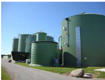
Biogasanlage in Borkow
