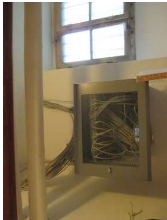
Sicherungskasten im Kellergeschoss
